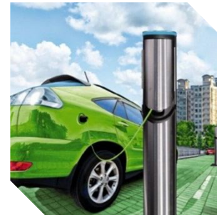
Ensto EV Charging
